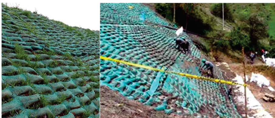
Figura 18. Malla talud para el control de la erosión, con siembra para añadir cobertura vegetal.
