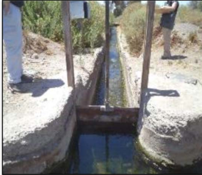
Figura 3-62 Bocatoma canal Berna
