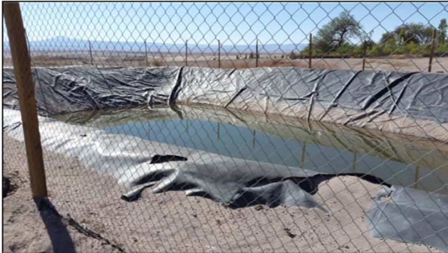
Figura 3-98 Estado actual de un reservorio con roturas en lámina impermeable
