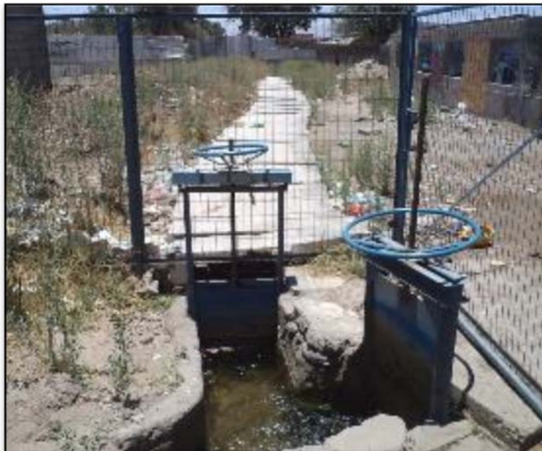
Figura 3-65 Bocatoma canal Radic
