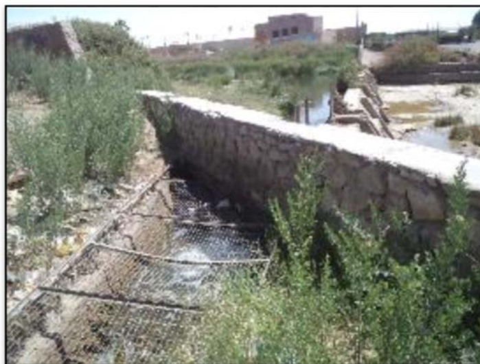
Figura 3-67 Bocatoma canal Chunchuri Bajo
