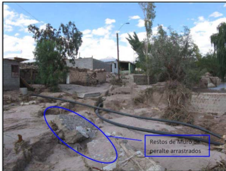
Figura 3-45 Efecto en el tranque por crecida en febrero del 2012
