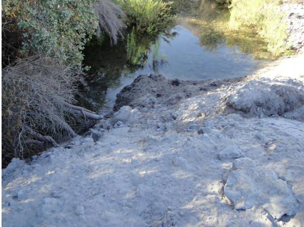
Foto 3: N: 6381733.17, E: 300483.15. UTM (WGS-84). GPS 116. Obstrucción Estero El Sauce Sector Oriente
