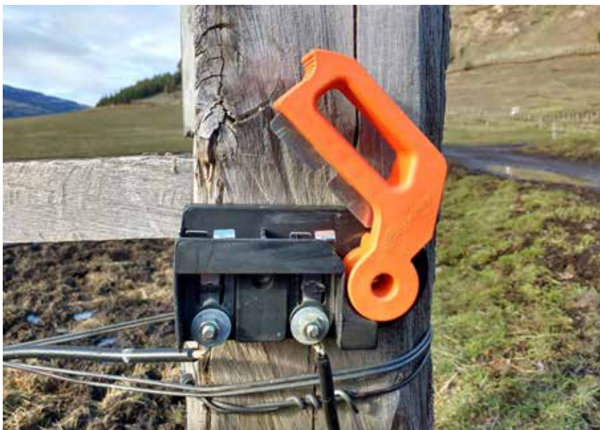
Figura 8.8. Interruptores para cerco eléctrico.
