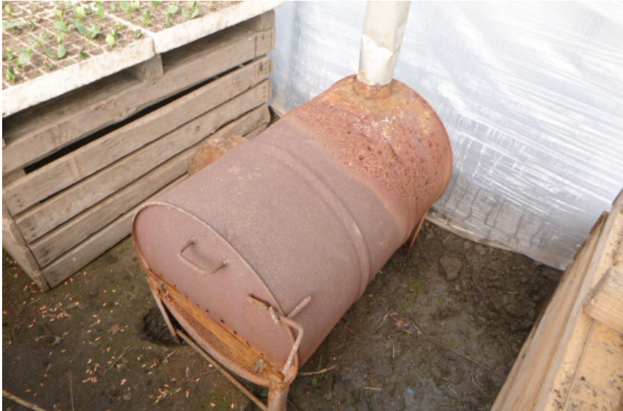
Figura 6.4. Calefactor a combustión externo para aumentar temperatura del invernadero.
